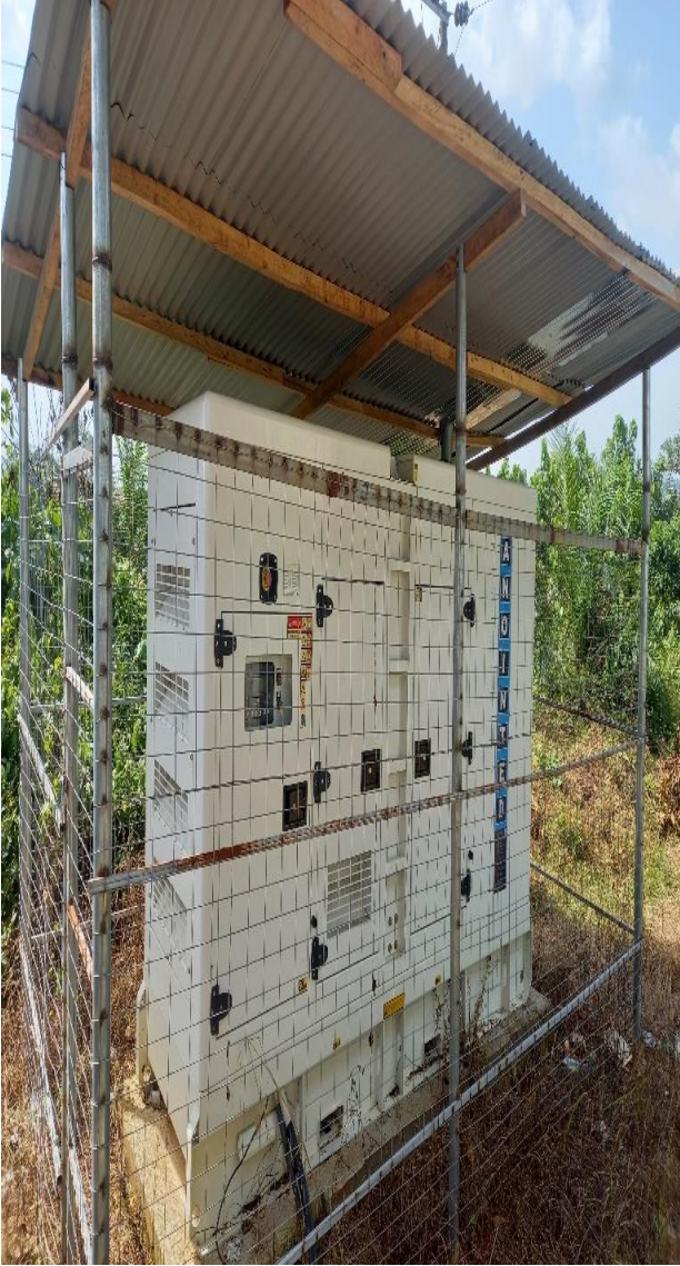
16. Procured 1No. Generator Set
